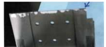
Figure 2 Détériorations constatées avant réparation
